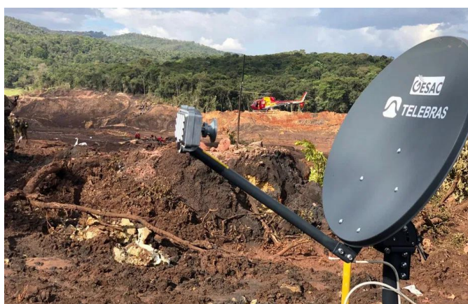
Figura 15 - Antena de comunicação satelital instalada em área rural - Fonte: Ministério das Comunicações
